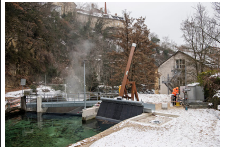
Dans le haut du vallon de la Serrière, un dégrilleur a fait son apparition.
